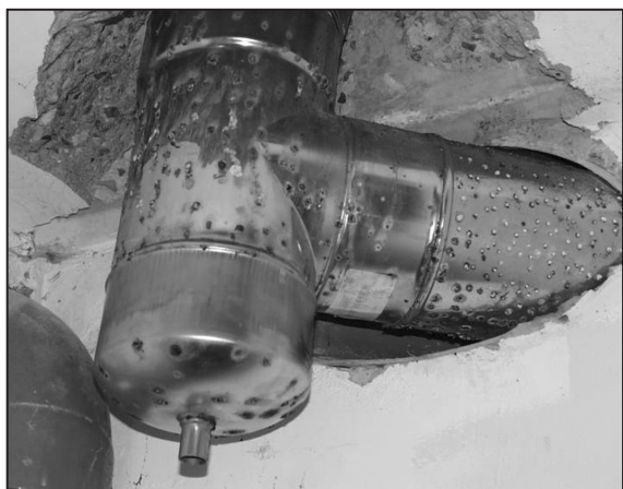
Photo 1. Détérioration nette d'un conduit d'évacuation desservant une chaudière dans un logement situé au-dessus d'un pressing.
